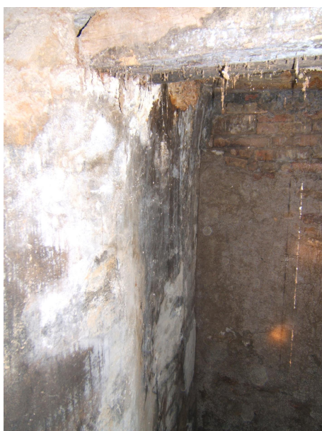
Interno piano terra lato interrato (infiltrazioni)
