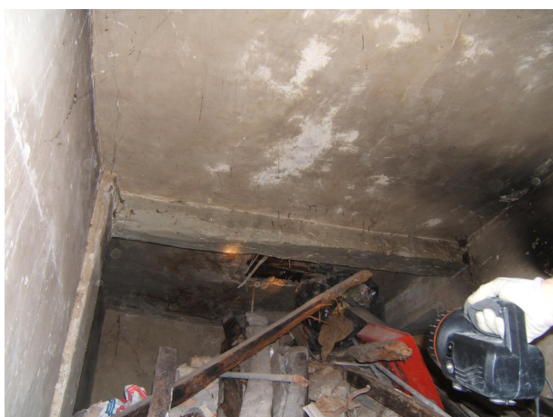
interno piano primo dal n° civico 65 foro di scarico sul solaio piano secondo
