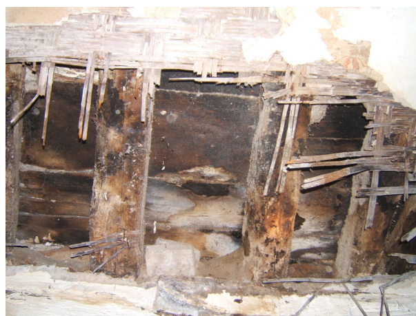
interno piano primo dal n° civico 65 infiltrazioni dal sovrastante vicolo Cassini n.56
