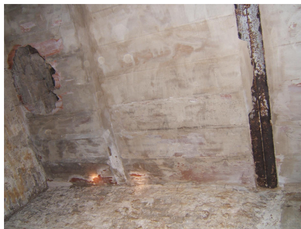
Foro di scarico solaio intradosso secondo piano lato numero civico 69
