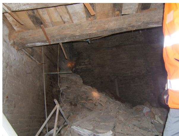
interno piano terra dal n° civico 69 (detriti)
