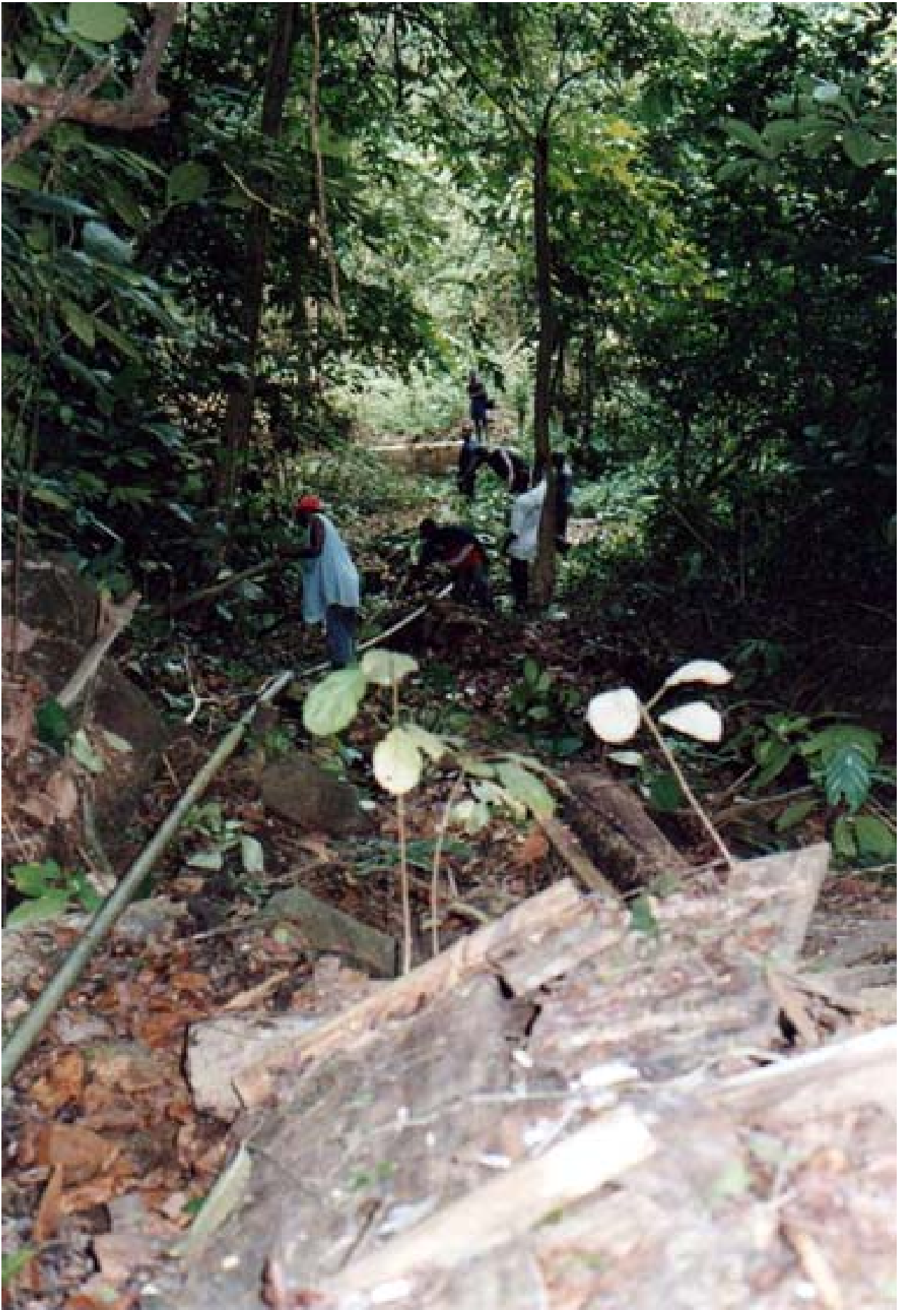
Linea di tubazione che collega le diverse strutture di raccolta.
