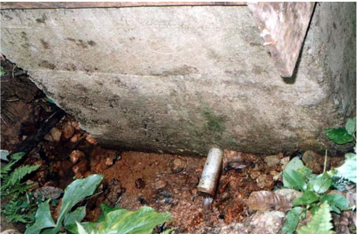
Particolare della struttura di sedimentazione e filtrazione dell'acqua.
