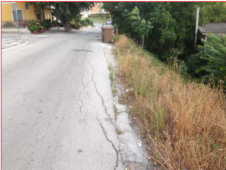
Foto n° 2 – Carreggiata dissestata in prossimità del ciglio della scarpata
